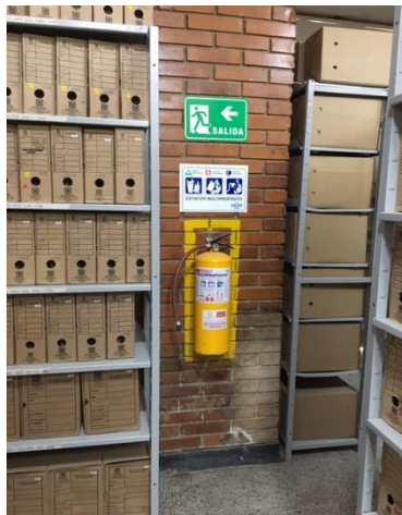
Foto No.9. Ubicación extintor multipropósito espacio No. 2
