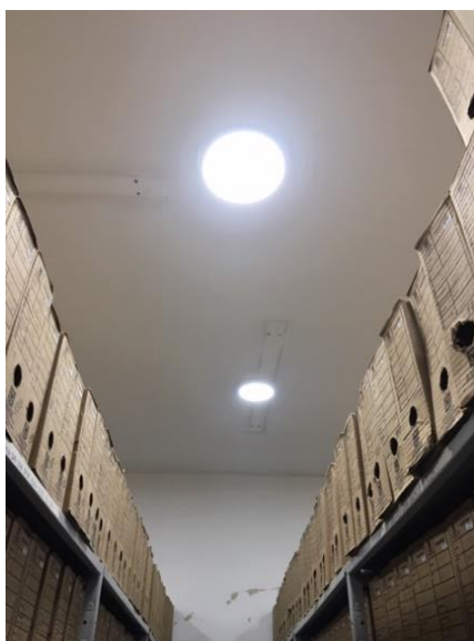
Foto No.3. Iluminación LED para el espacio 1
