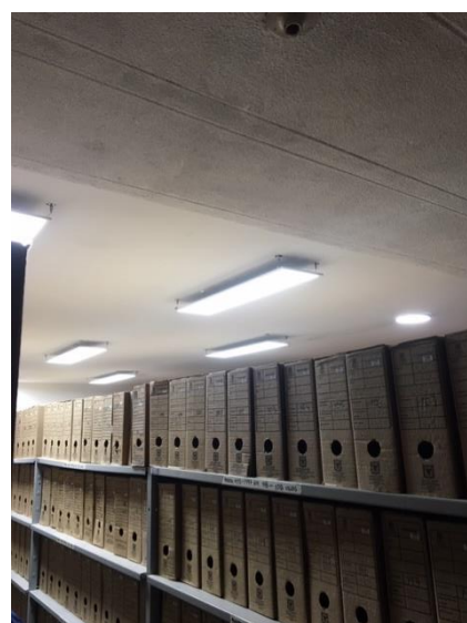
Foto No.4. Iluminación LED para el espacio
