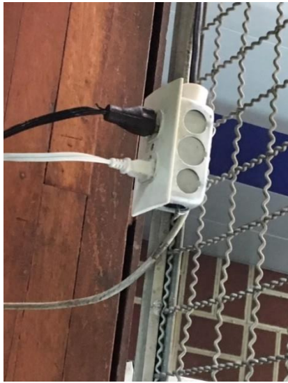
Foto No 15. Detalle instalación eléctrica segundo nivel
